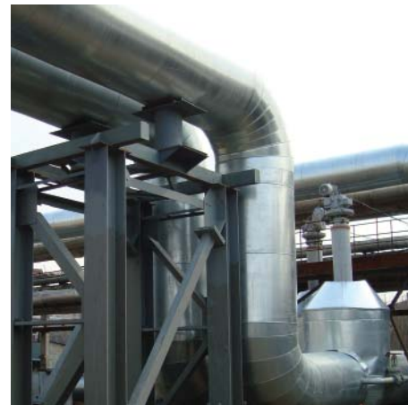
Системы вентиляции, кондиционирования и трубопроводы
